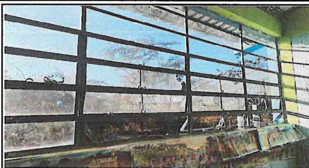
Sustitución de 40 vidrios rotos y faltantes, en ventanales de aulas.
